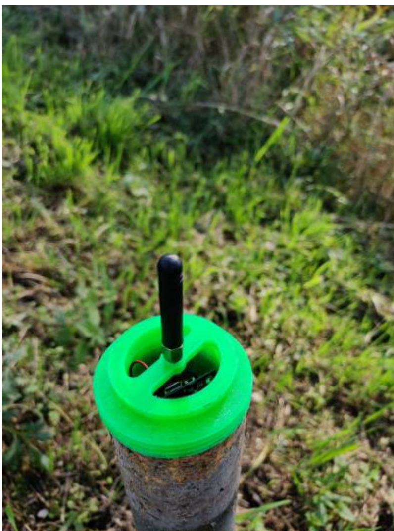
Fig. 8: Sensor und LoRa-Sender im Rohr installiert
